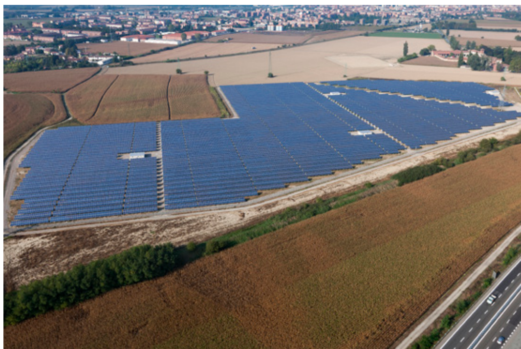
Impianto fotovoltaico di Alessandria Sud (AL)
