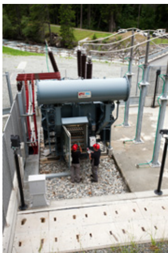
Trasformatore elettrico della centrale di Torrent situata tra i comuni di Pré-Saint-Didier e La Thuile (AO)
