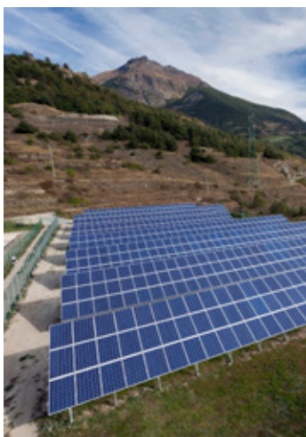
Impianto fotovoltaico La Tour di Quart (AO)
