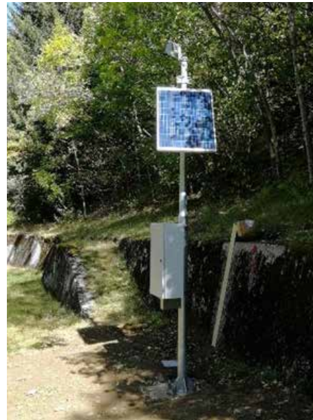
Stazione presso i punti di misura e vista dell'interno del quadro.
