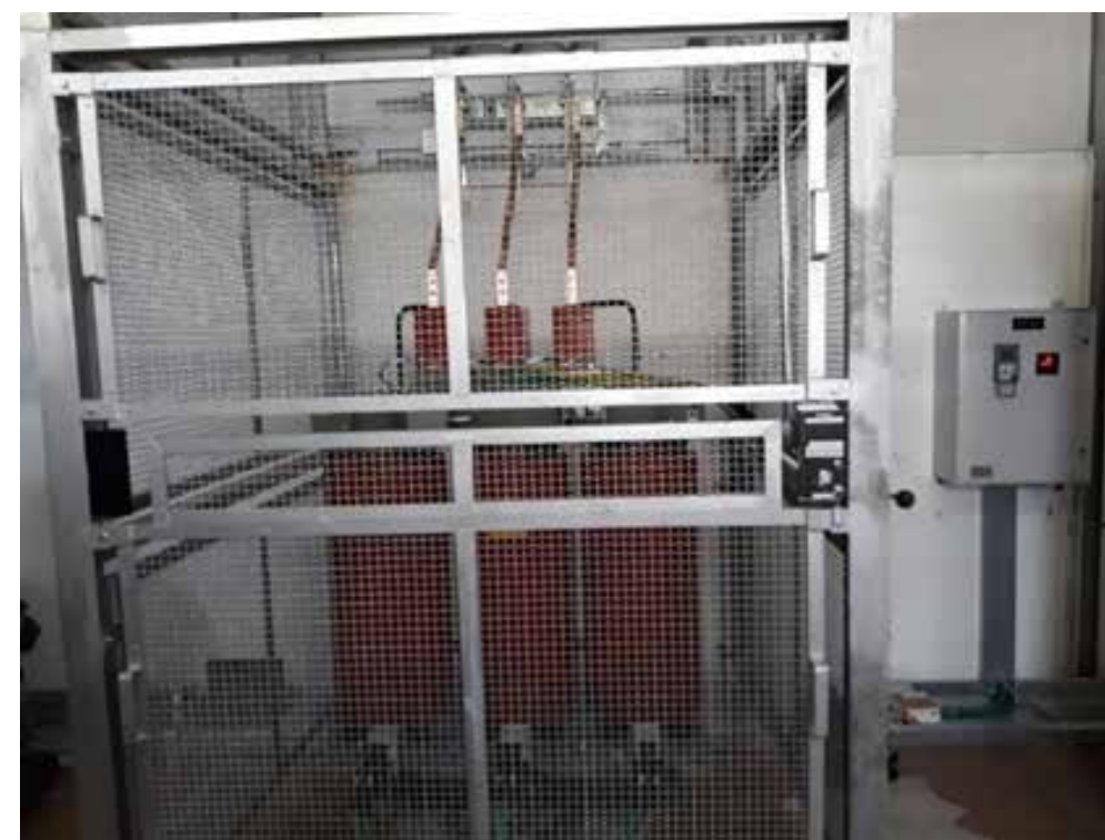
Trasformatore di eccitazione (TE)
