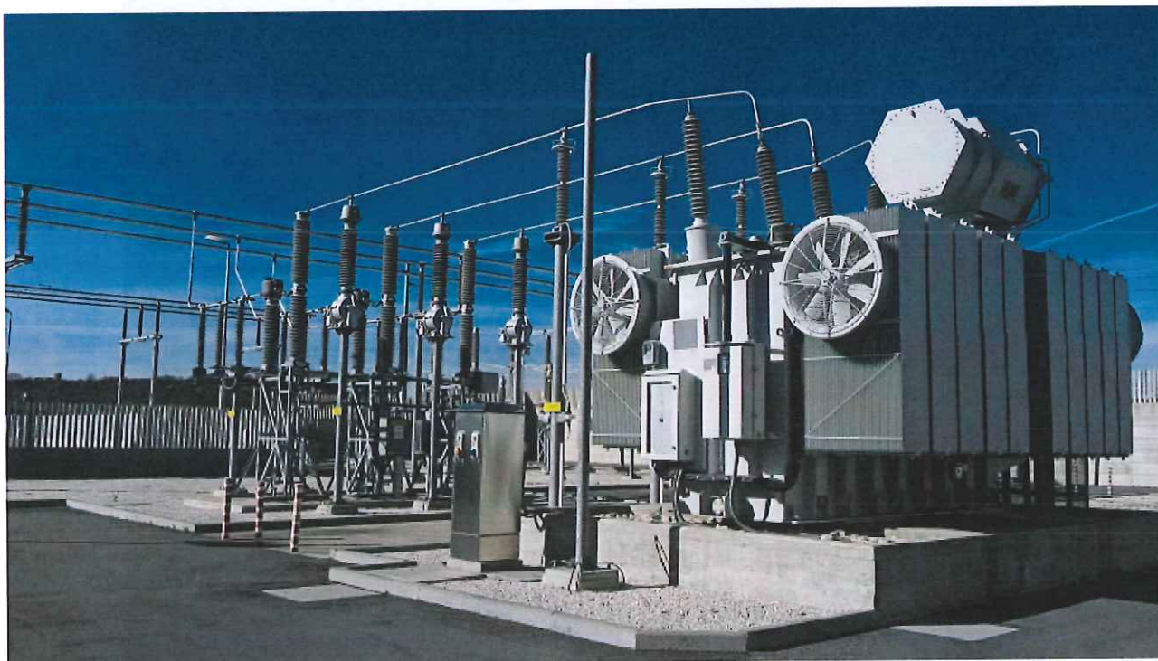
Foto 4 : Trafo MT/At ABB
