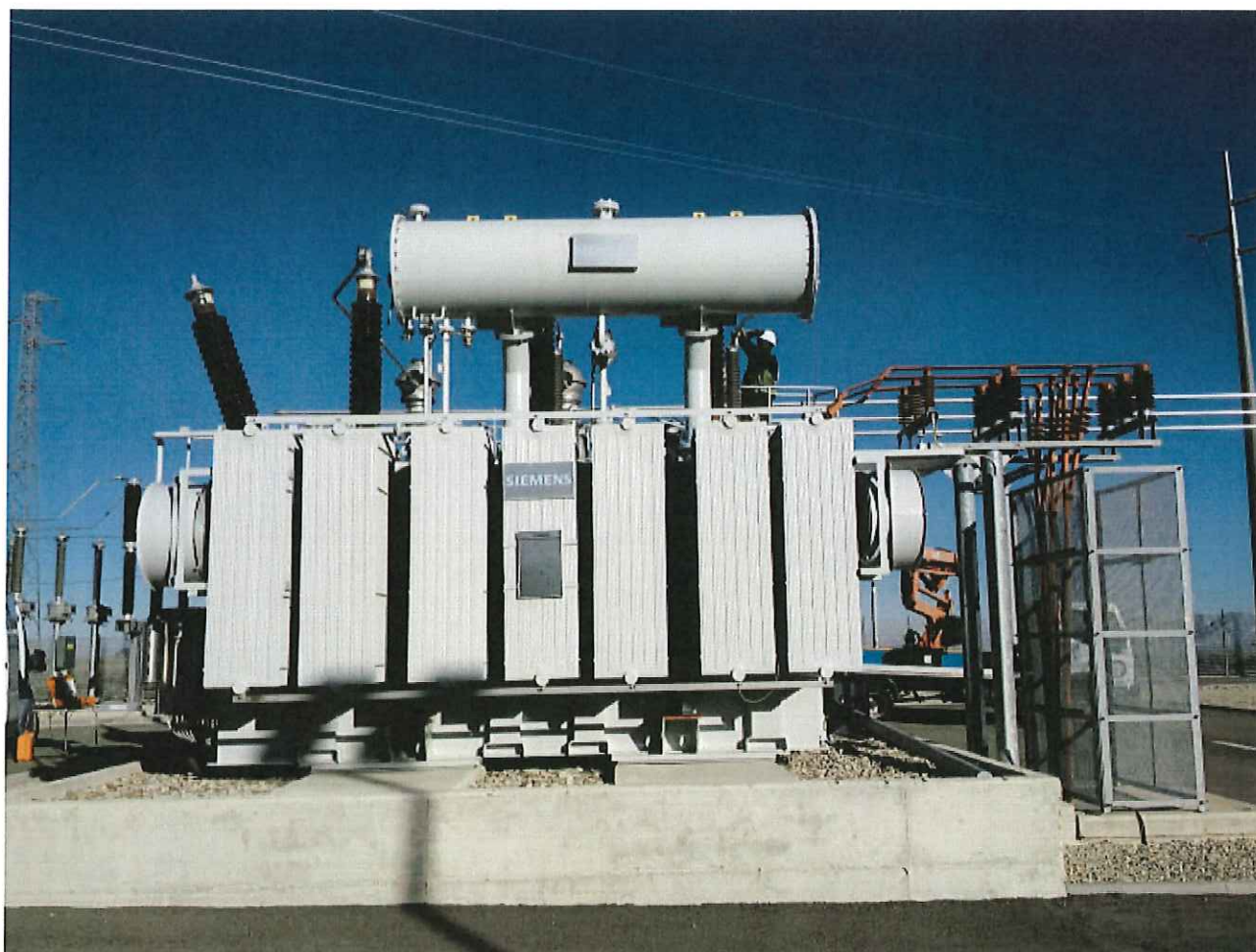
Foto 4 : trafo MT/AT Siemens
